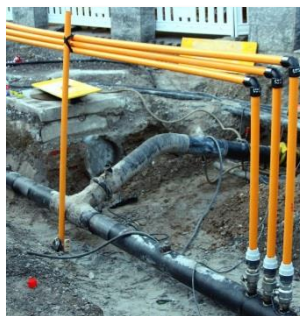
Die zu hohe Gasleitung
